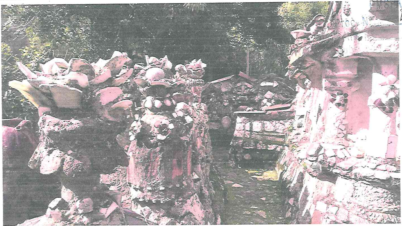
Figura 10: Imagem do acesso principal. Se comparado a fotos mais antigas, nota-se a evolução da degradação ornamental (musgos e outros ataques biológicos, além de perda de volume das composições, pela perda de peças). Fonte: Ivo Barreto, Junho/2020.
