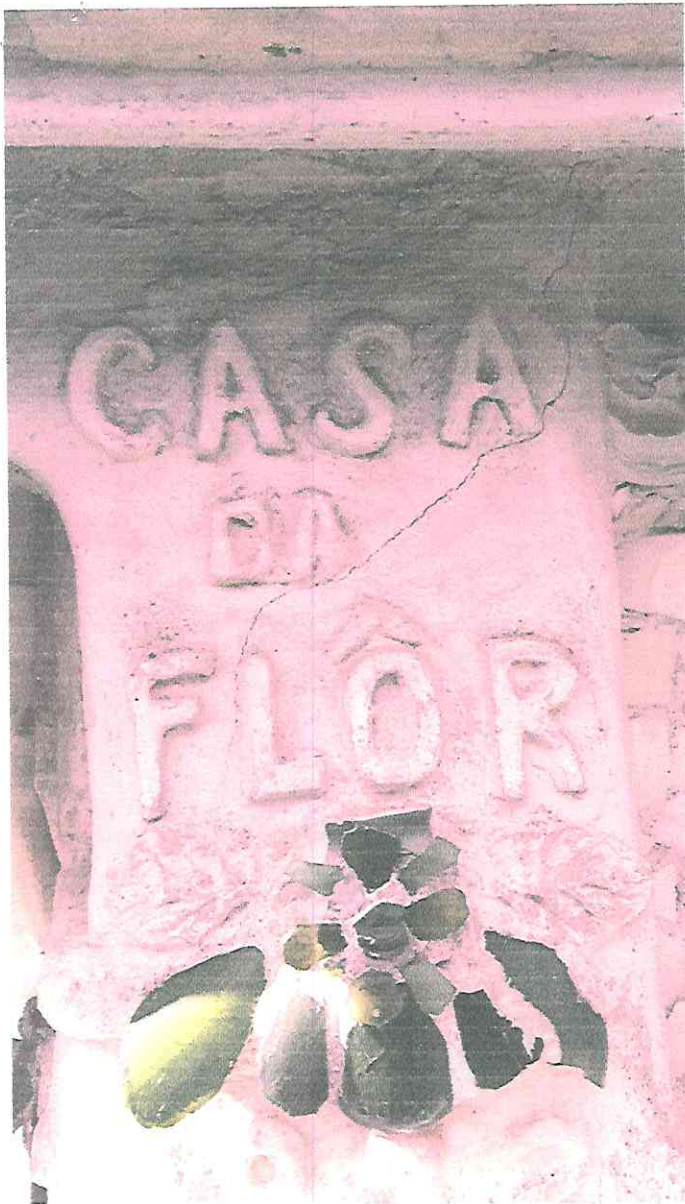
Figura 13: Enfeite do acesso, rerepresentando a fissura tratada em 2013 . Fonte: Ivo Barreto, Junho/2020.
